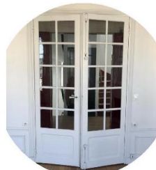
Portes intérieures : 28 unités 1,8 tonnes
